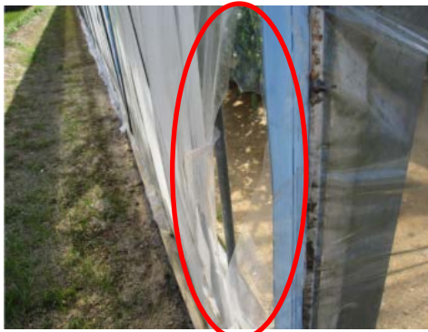
ビニールの破損
