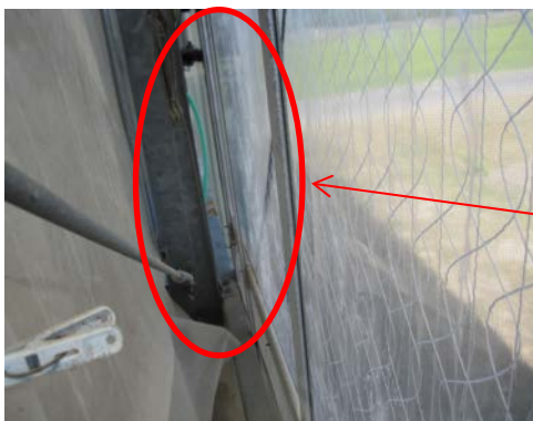
内側の扉の横にある隙間(約20cm幅×2m)
