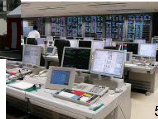
高機能消防指令センター
