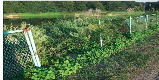
【事例2】安全柵に破損箇所や隙間がある(21事例)
