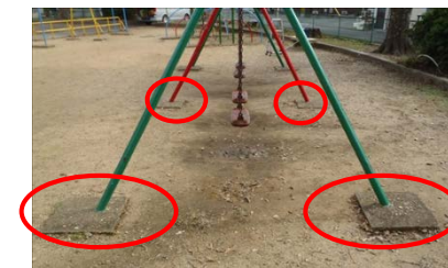
ハザード3: 落下の可能性のある基礎部分の露出
