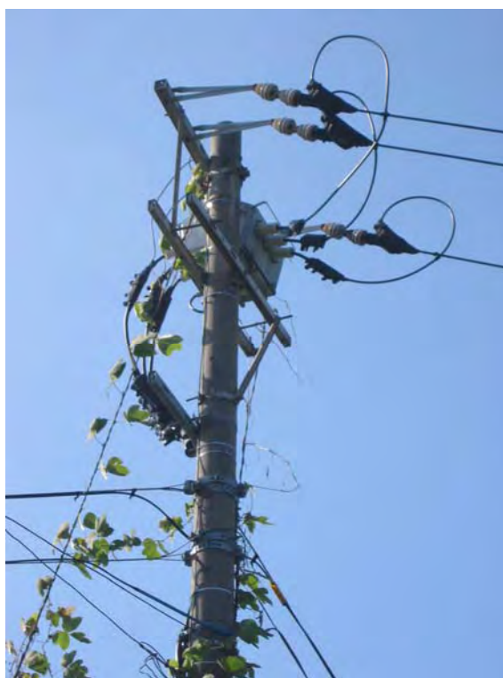
図2 植物が巻きついている構内1号柱
