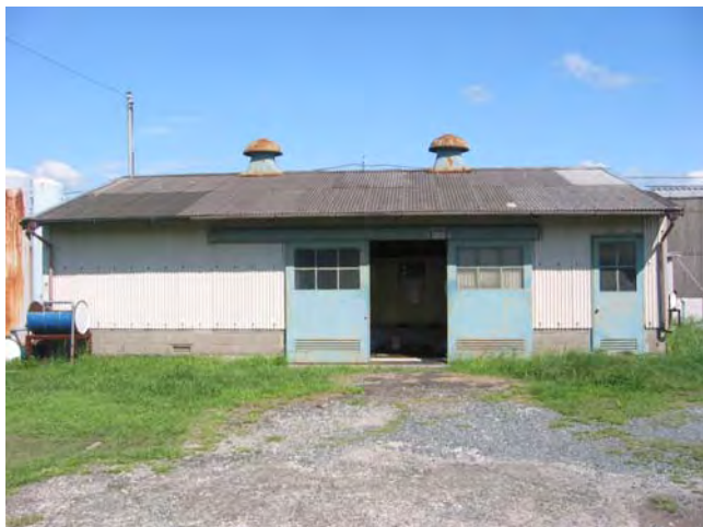
写真7 高圧受配電設備を格納する建物に隙間があり、小動物が侵入するおそれがある。
