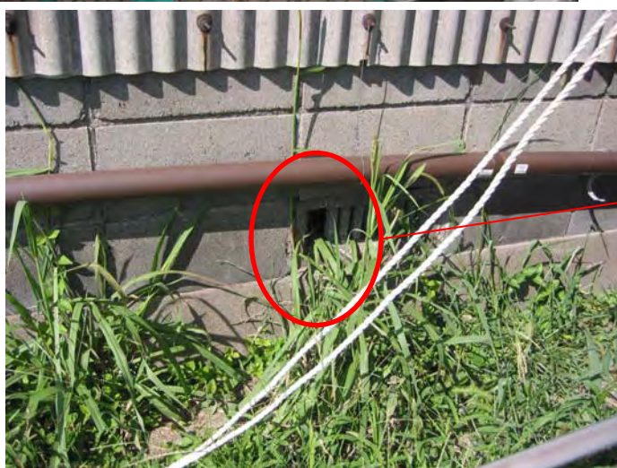
小動物が進入するおそれのある箇所（換気口が破損している）
