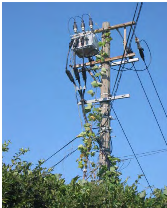
図1 植物が巻きついている構内1号柱
