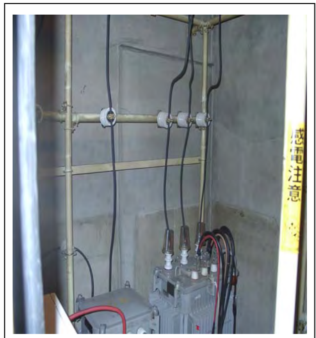
図2 高圧受配電設備（2階）
