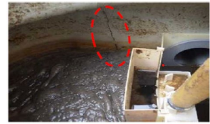
特定既存単独槽の例 (漏水を伴う亀裂)
