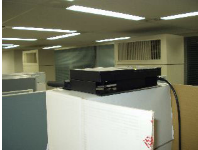
写真 2. 16 AP-2500 設置状況(横)
