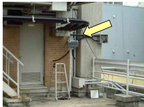
写真 1-6-8 山梨県庁基地局装置
