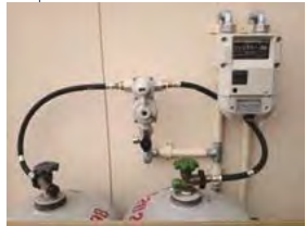
ガス計測装置
