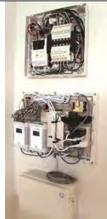
電力計基幹部
