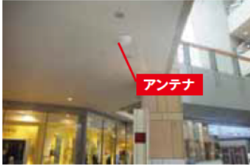
アンテナ設置例
