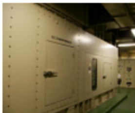
通信局舎の自家発電機
