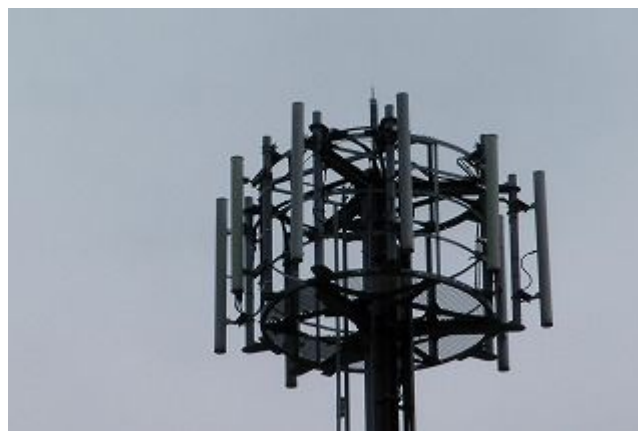
基地局アンテナ
