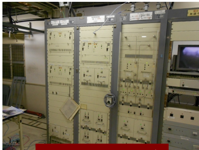
STL/TTL/TSLラック 制御・監視・番組
