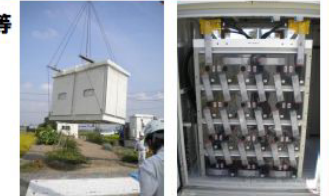
(バッテリー収容箱) (バッテリー)
