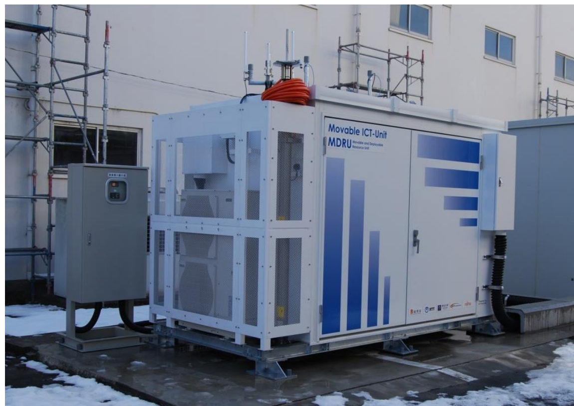
昨年開発した中型移動式ICTユニットの外観
