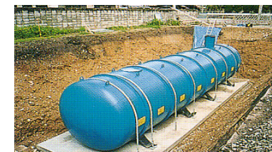
耐震性 貯水槽
