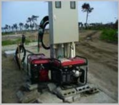
可搬型発電機
