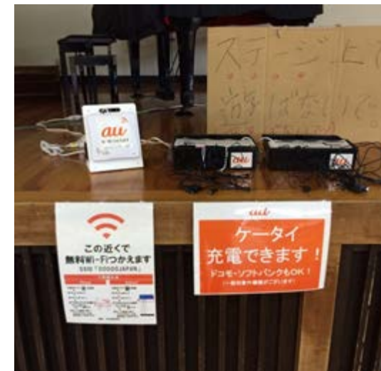
避難所への特設Wi-Fiの設置
