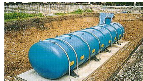
【消防防災施設整備の促進】 (耐震性貯水槽)
