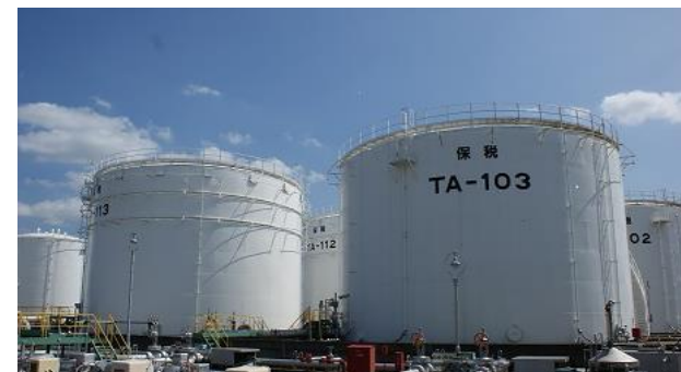
【危険物施設の例(屋外タンク)】
