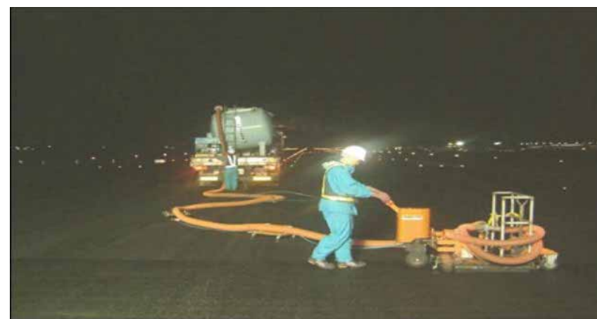
●ゴム除去工: ハイドロプレーニング現象を防止するために、路面に付着している航空機タイヤゴムの除去、清掃を実施している。
