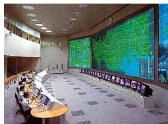
交通管制センター
