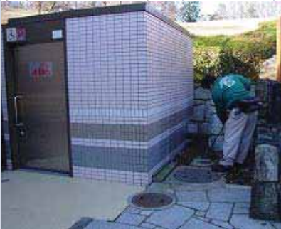
多目的トイレ止水栓
