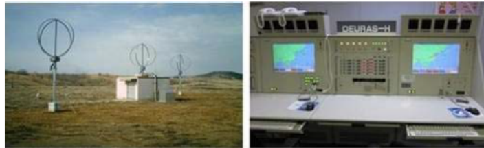
DEURAS-Hアンテナ(センサ局)及び監視卓(集中センタ局)
