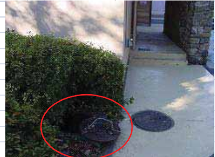
一般トイレ止水栓
