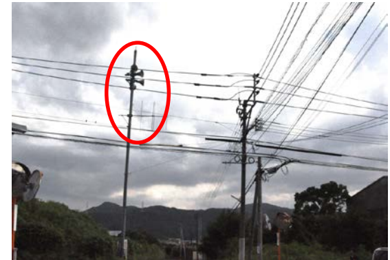
障害のあった防災行政無線の同報子局
