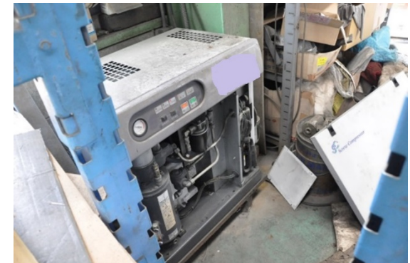
妨害源となったコンプレッサ
