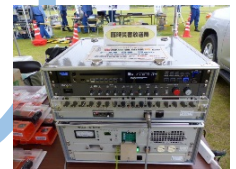
臨時災害放送局設備 (石川県への貸出し) (北陸総合通信局)
