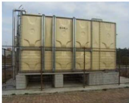
飲料水貯水槽
