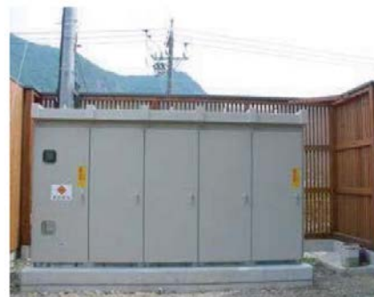
非常用電源装置
