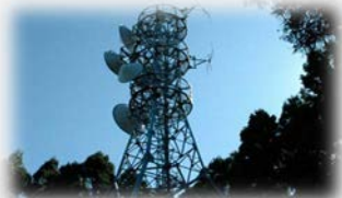
防災行政無線設備の被災
