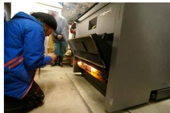
▲町内で導入された薪ボイラー
