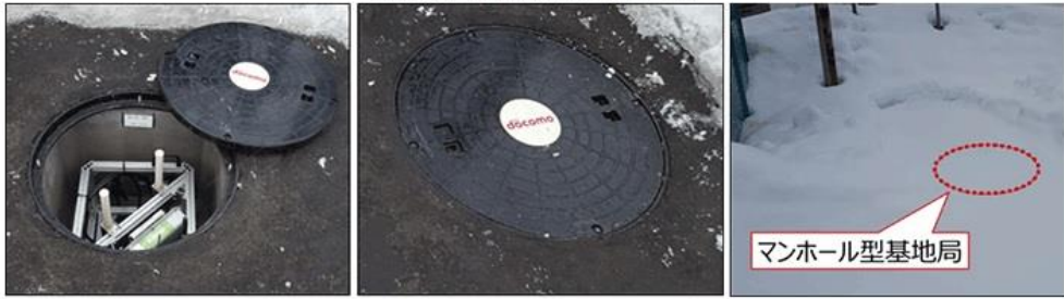
<マンホール型基地局のイメージ>
