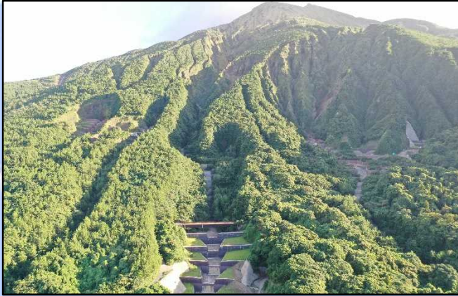
松浦川地区荒廃及び復旧状況
