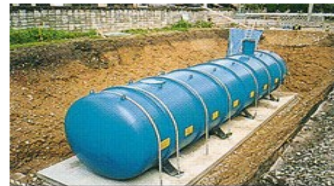
【耐震性貯水槽】
