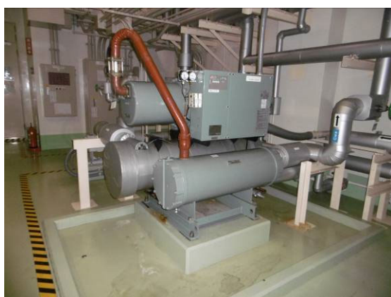
冷水・冷却水設備
