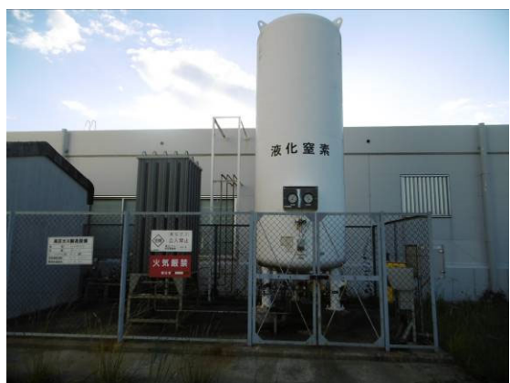
一般高圧ガス製造施設設備
