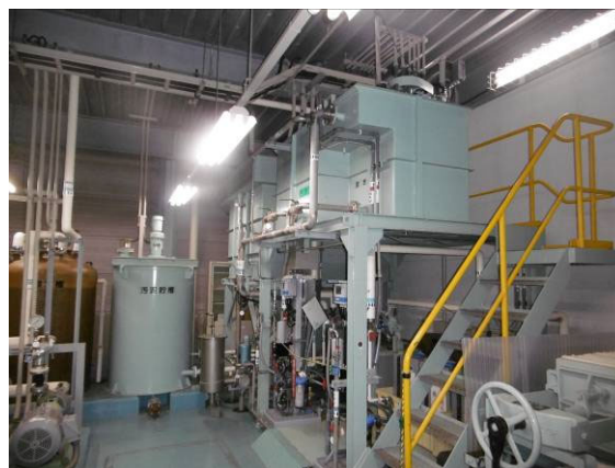
排水処理設備
