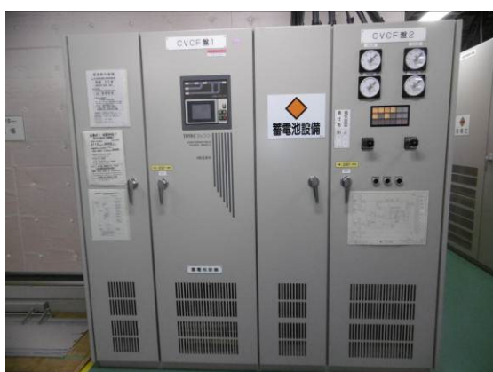
無停電電源装置設備
