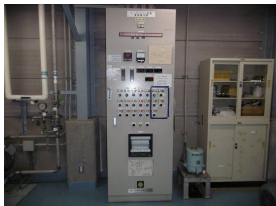
ユーティリティ排水設備
