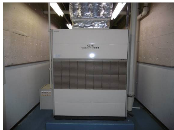
換気空調設備
