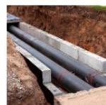
管路 約60万km
