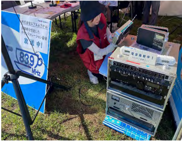
(防災局用放送設備の調整)
