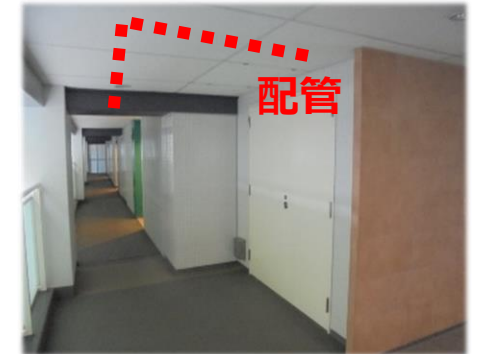
横系(廊下天井)
