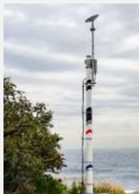
衛星回線を活用した基地局
