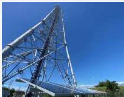
太陽光発電を電源にした基地局
