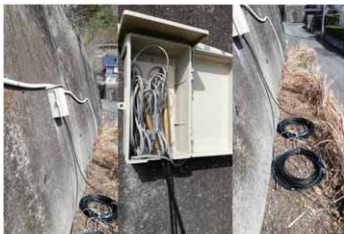
図 付録-3 センスアンプの収納状況
