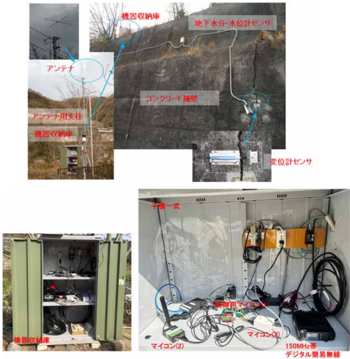
図 4-5 センサ設置箇所の設置状況
