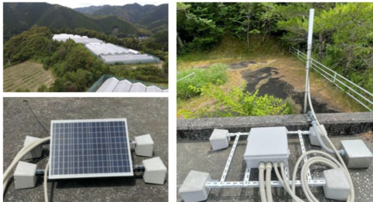
図1 無線テレメータシステム（水位計）の例
