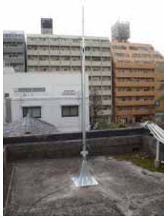
図 4.2. 83 アンテナ設置例
