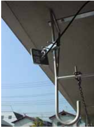
図 4.2. 85 アンテナ設置例
