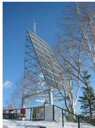
支笏湖スカイロード基地局 (10kW)
