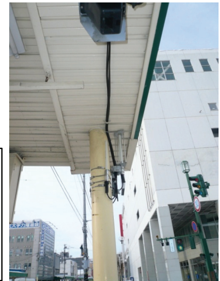
3, 4番基地局 アンテナはアーケード支柱に設置
