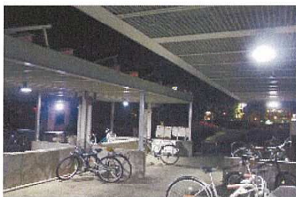
LED駐輪場照明 = 県提供
