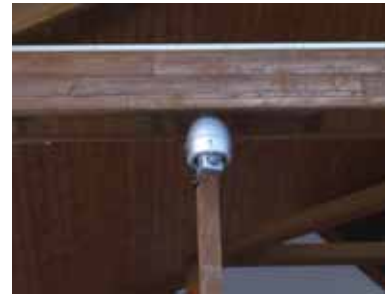
管理棟に設置したWeb監視カメラ
