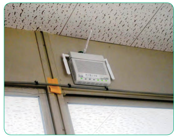
(参考) 教室天井近くの壁に無線LANアクセスポイントを設置した例 (西与賀小学校)
