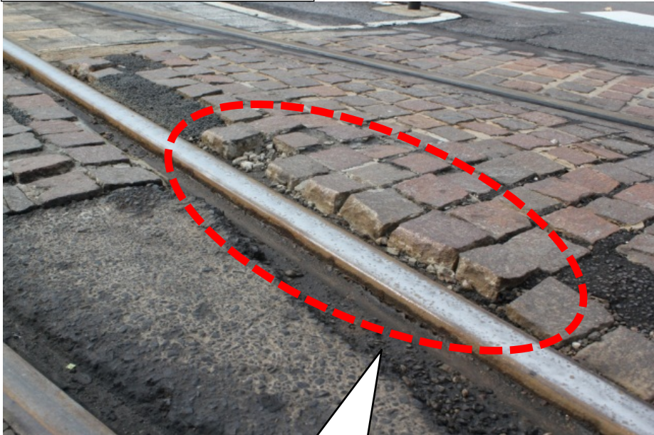
横断歩道の軌道敷の凹凸
