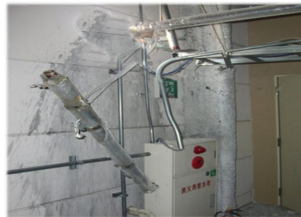
地震の揺れによりスプリンクラー設備が破損 (提供:仙台市消防局)
