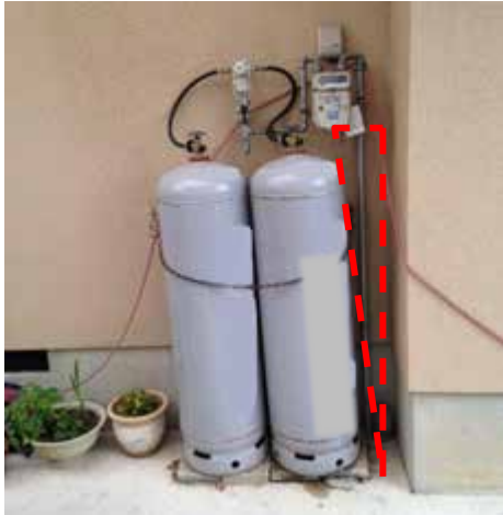
容器が、壁がない左側に傾いている。
