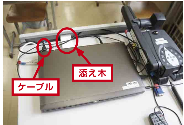
PCが壁面に押されてケーブルが破損しないように設置された添え木 (横浜国立大学教育人間科学部附属横浜中学校)
