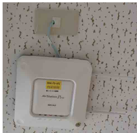
PoEハブから電源供給を受けている無線LANアクセスポイント (哲西中学校)
