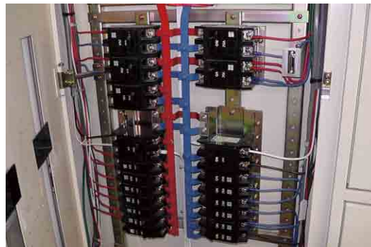
充電保管庫の電源を確保するために新たに分電盤を設置した例 (上越教育大学附属中学校)
