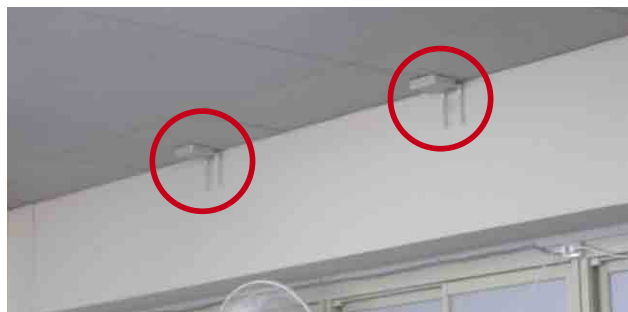
普通教室に2台無線LANアクセスポイントを設置した例 (三雲中学校)
