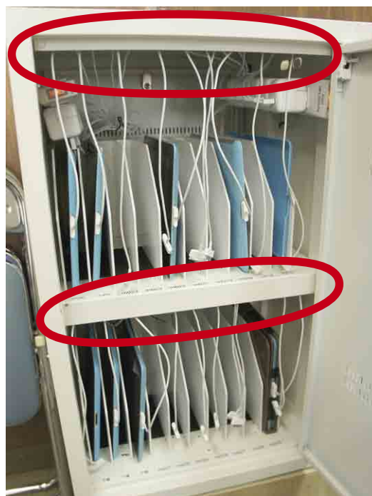
充電保管庫のACアダプターをケーブル止めで天板の裏側に固定した例 (三雲中学校)
