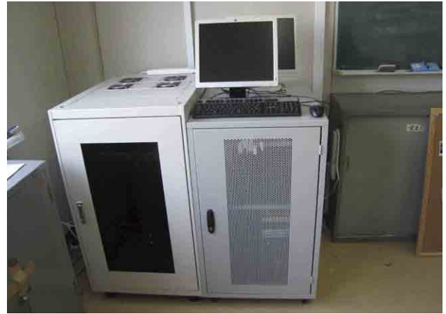
相談室に設置されたサーバーラック (三雲中学校)
