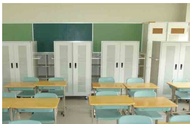
充電保管庫を空き教室に設置した例 (武雄青陵中学校)
