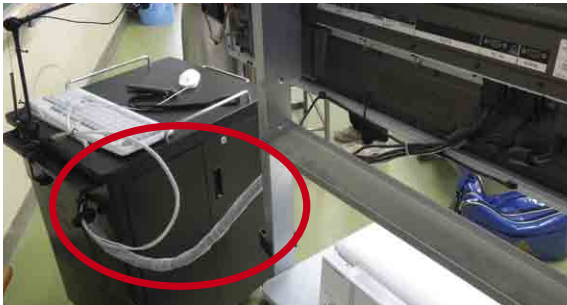
生徒の安全に配慮して機器の配線を整理した例 (城東中学校)
