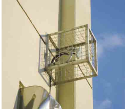
屋外に設置した無線LAN アクセスポイント (哲西中学校)
