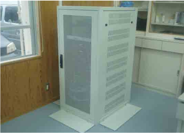
PC教室に設置されたサーバーラック (下地中学校)
