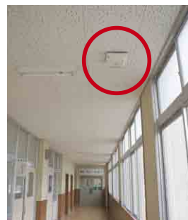
廊下に無線LANアクセスポイントを設置した例 (哲西中学校)
