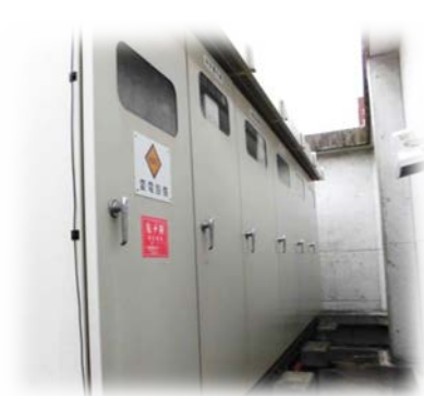
キュービクル式高圧受電設備
