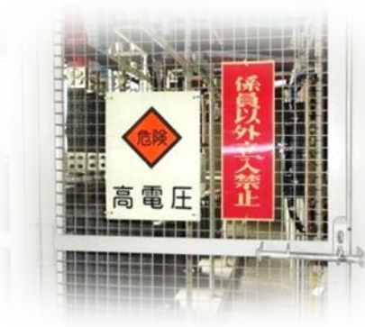
変電設備等が設置された部屋の入口
