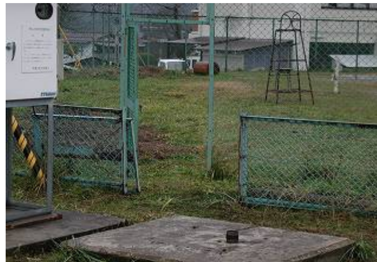
観測所のフェンスが破損しており、超音波式積雪計の測定範囲内に人や動物が入り込み観測に影響が出ることが懸念される
